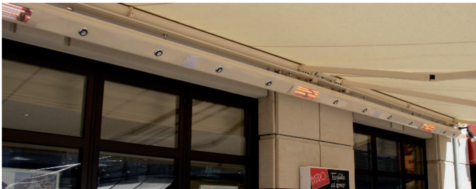
Hilton Hotel in Dresden. SOLAMAGIC Licht-Wärme-Sound mit einer Gesamtlänge von 100m
